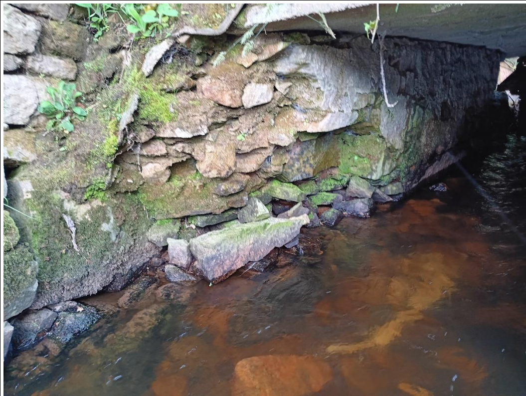
Photo 5 : Effondrement partiel piédroit rive droite côté aval
