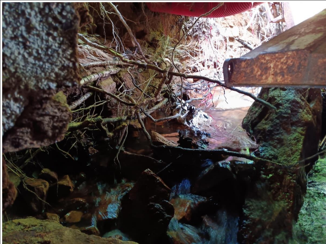
Photo 6 : Effondrement partiel piédroit rive droite côté amont
