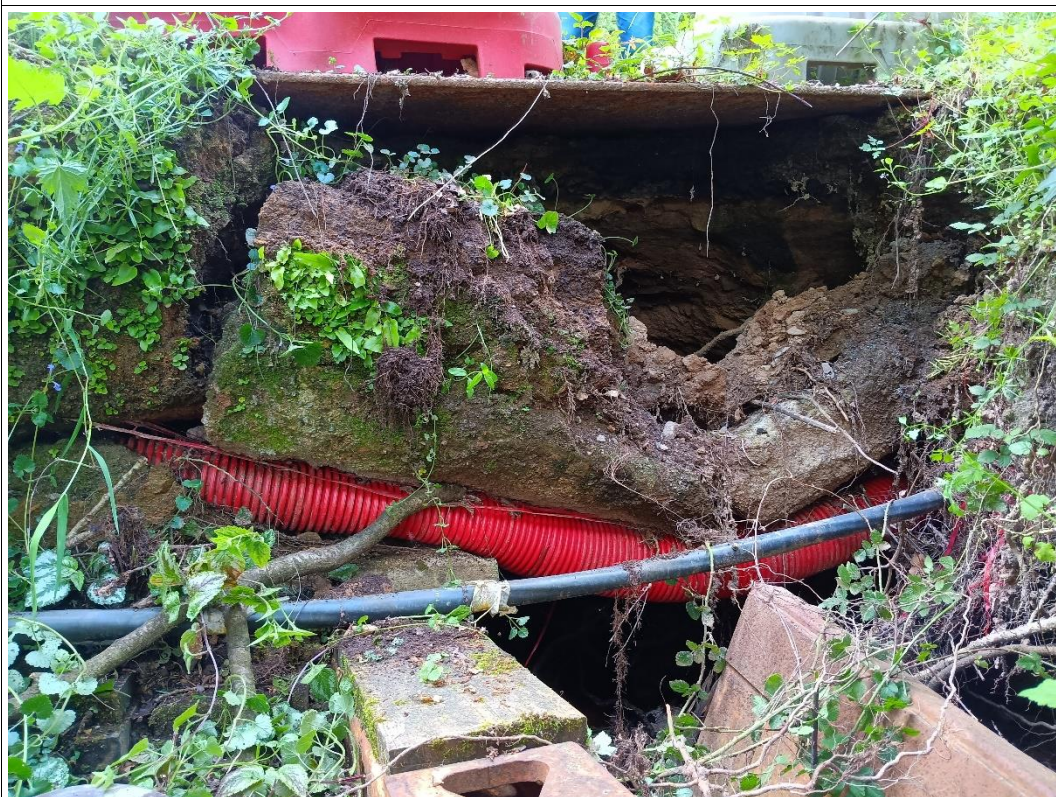
Photo 4 : Elévation amont, rupture et effondrement du tablier dalle béton
