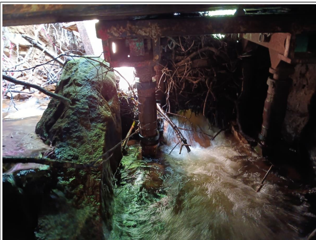
Photo 9 : Etaisement provisoire, Effondrement et embâcles
