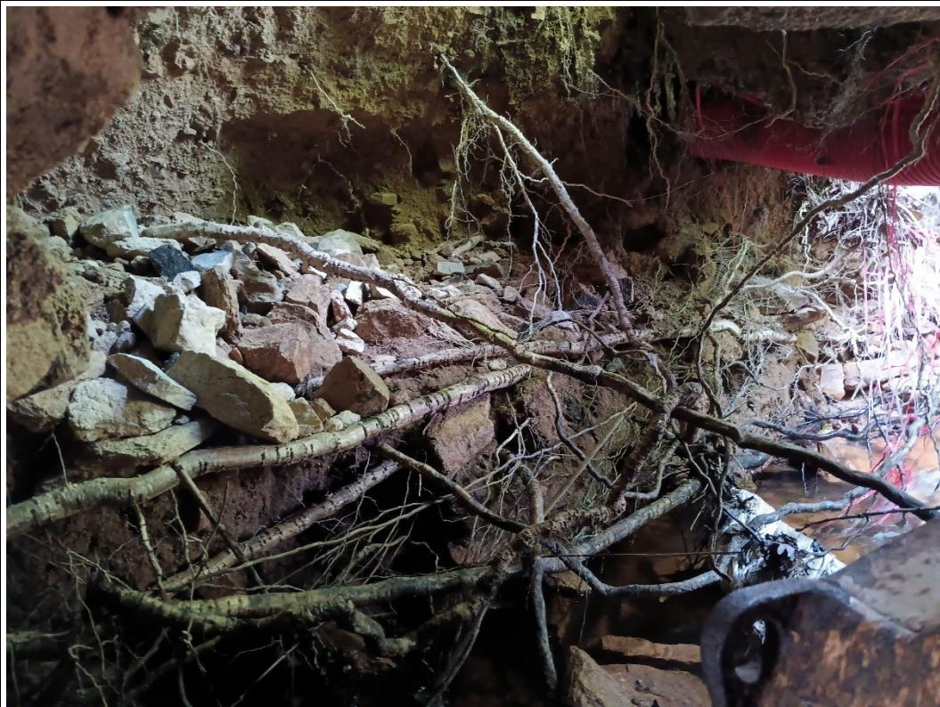
Photo 7 : Effondrement partiel piédroit rive droite côté amont et affouillement
