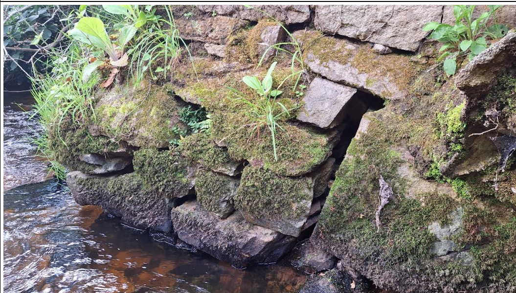
Photo 8 : Fracture et désorganisation du mur en retour rive droite côté aval
