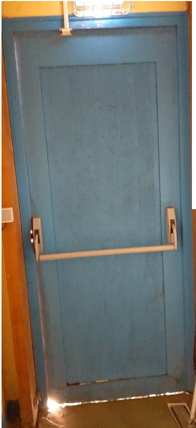
Issue de secours de l'étage
