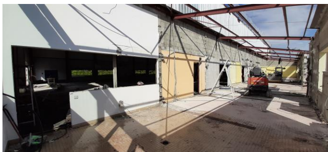
Création d'ouvertures – pignon Sud et façade Ouest et, au premier plan, ouvertures créées entre le club house et le plateau sportif
